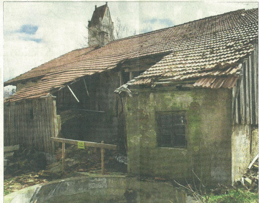
Das „Rochel-Haus“ von hinten: Teile des Dachstuhls sind eingestürzt – reine Kosmetikmaßnahmen von außen sind also längst nicht mehr ausreichend.
