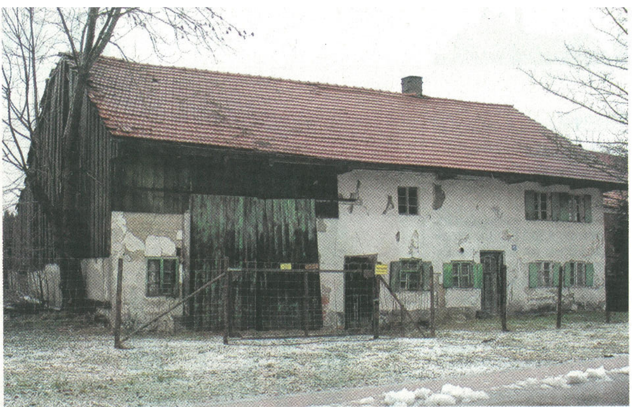
Der Zahn der Zeit nagt längst am alten Rochelhaus. Das Landratsamt fordert jetzt die Notsicherung.
